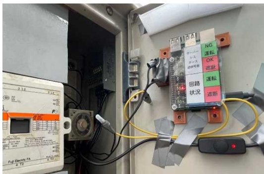
内製した自動停止装置(制御部改造部分)
